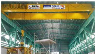
Der stabile Kran mit einer Spannweite von 24 Metern wurde erst am Einsatzort aus drei Teilen zusammenmontiert.
