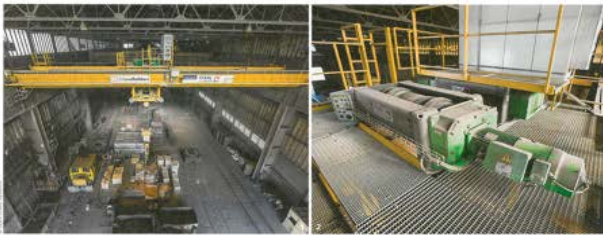
1 Kranstechnik von Stahl Crane Systems sorgt bei Nedstaal für einen wirtschaftlichen und wartungsarmen Betrieb der Krananlage. Nach hebe sich der Kran strahlend gelb vom Rest der Halle ab. 2 In nur wenigen Wochen hat sich auf ihm eine dicke Staubschicht gebildet. Den robusten AS-7-Seilzügen macht das nichts.
