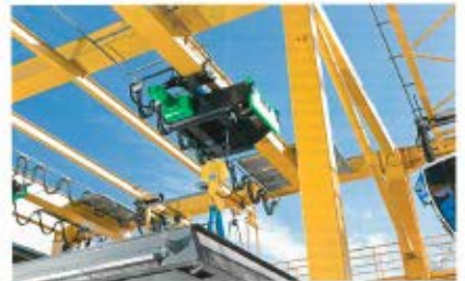
➌ Für ein kompakteres Hilfsbauwerk konzipierte Stahl ein spezielles Einschienenfahrzeug. Damit kombiniert der Selbstzug kompakte Abmessungen mit einer hohen Gewichtsklassen-Erhaltung.
