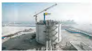
Auf den zwei 40 m hohen Tanks befindet sich je ein Wartungskran, mit dem die Flüssiggas-Pumpe herausgehoben werden kann
