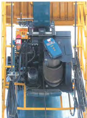
图1 STAHL CraneSystems 特殊定制的 LNG 葫芦符合 ATEX 指令，因此适用于危险区域
