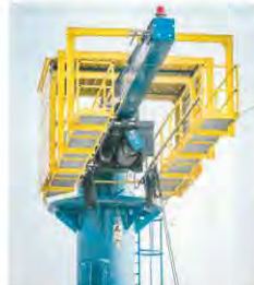
Um beim Seilwechsel besseren Zugang zum Hebezeug zu haben, wurden die Schwenkkrane beidseitig mit Wartungsbrücken ausgerüstet
