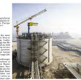
Auf dem 40 m hohen Tank steht ein Wartungsgerüst, mit dem die schweren Flüssiggas-Pumpe vom Fundament des Tanks zu den Montageort befördert werden kann. Bild: Stahl CraneSystems
