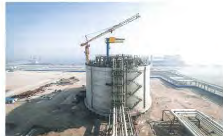
图2 一台用于维护的起重葫芦安装在 40m 高的液化天然气罐顶部，用于将液化天然气中的泵从罐中提升起来。柱形旋转式起重机经常用于 LNG 罐顶，将位于罐顶非常窄半径范围内的部件吊起
