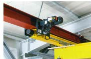
02 Auch die eingegliederten Fahrmotoren sind in explosionsgeschützter Bauweise ausgeführt
