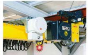
03 In einer druckfesten Kapselführung sind Kransteuerung und Fernempfänger sicher isoliert
