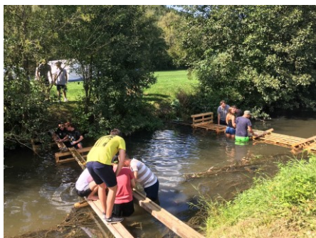
Die erste Aufgabe bei den STAHL CraneSystems Kennenlertagen: Gemeinsam eine Brücke über den Kocher bauen
