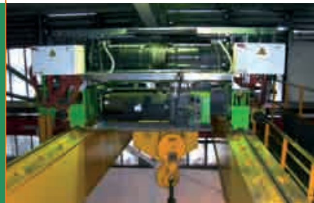
Das 35t Windwerk vom Typ SHWF mit einem Seilzug vom Typ SH als Hilfshub im Vordergrund.
