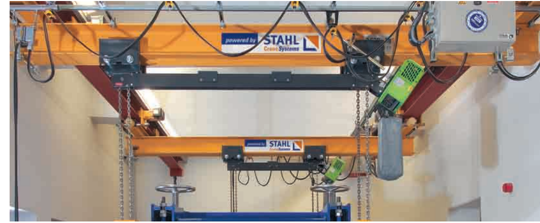
Mouvements de levage parfaitement synchronisés par un seul moteur de levage, déplacement absolument parallèle des chaînes, même en cas de sollicitation irrégulière.
